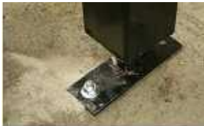
最後まで打込んだ写真です。
